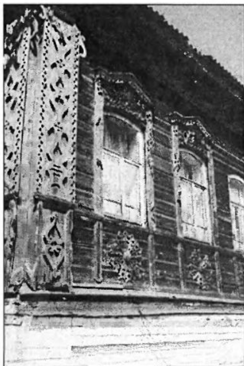
Накладные угловые пилястры предохраняют торцы бревен от гниения.
